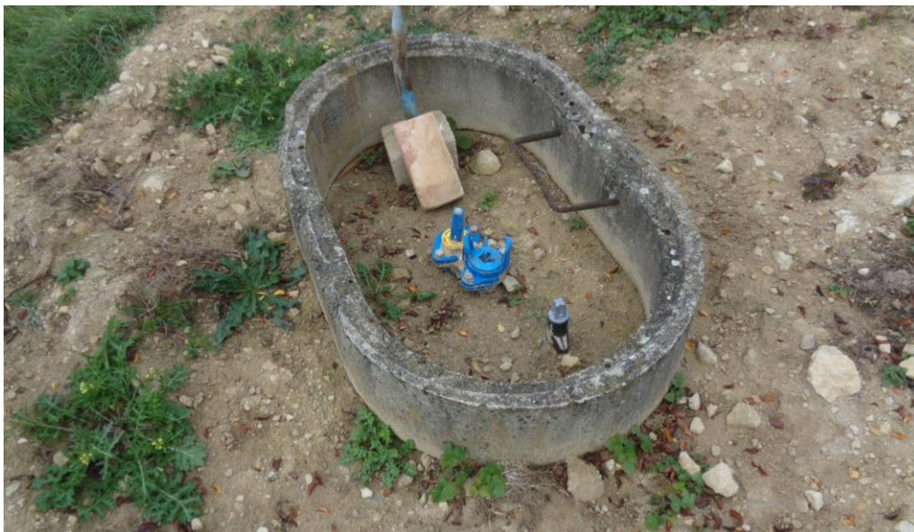
Pohled na stávající podzemní hydrant H732 – V70 st. 5,5324 km
