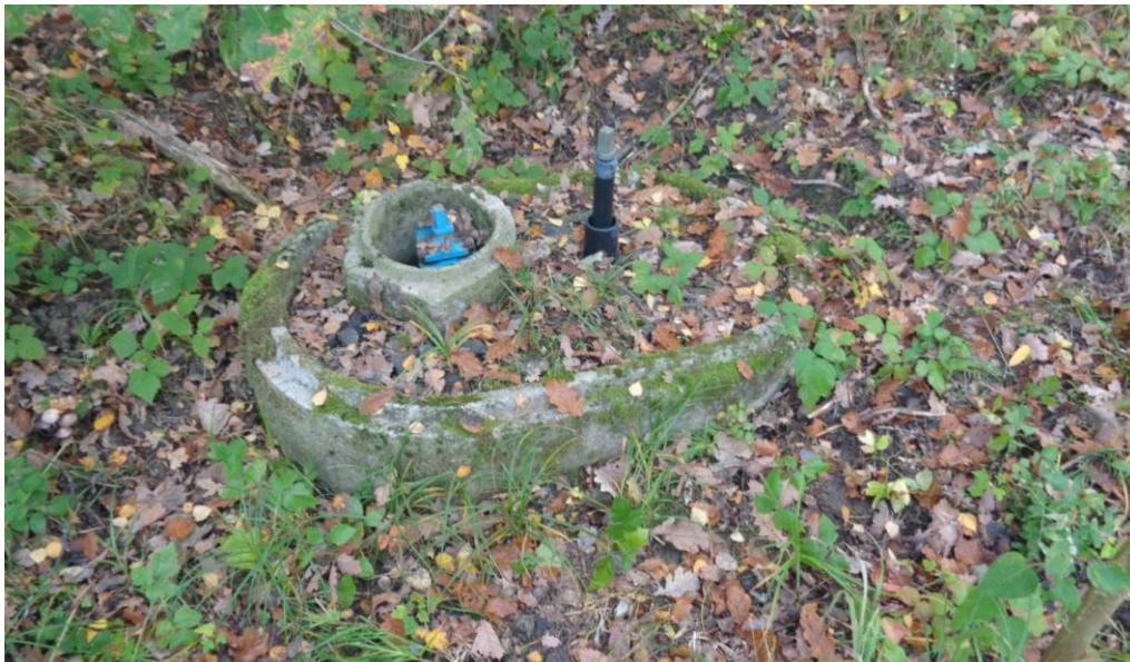
Pohled na stávající podzemní hydrant H737 – V46 st. 3,8504 km
