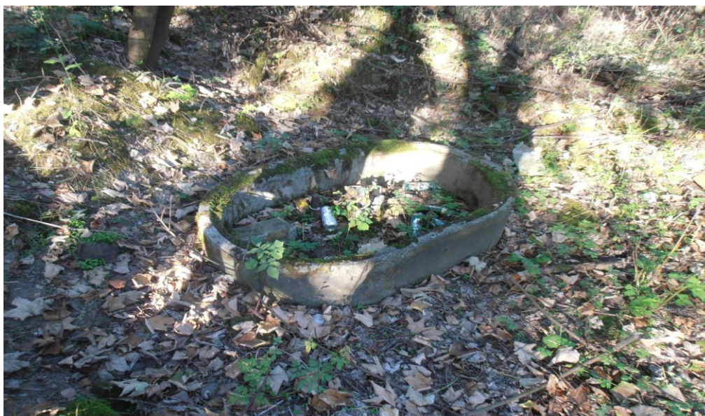
Pohled na stávající podzemní hydrant H56 – V17 st. 1,1454km
