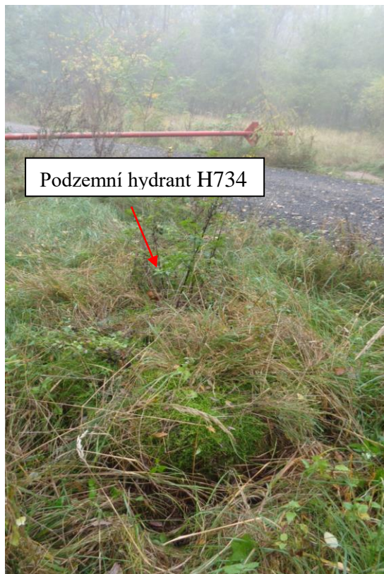
Podzemní hydrant H734 – V60 st. 4,9300 km
